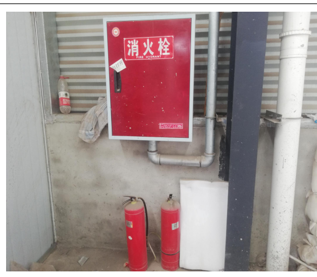
消火栓、灭火器
