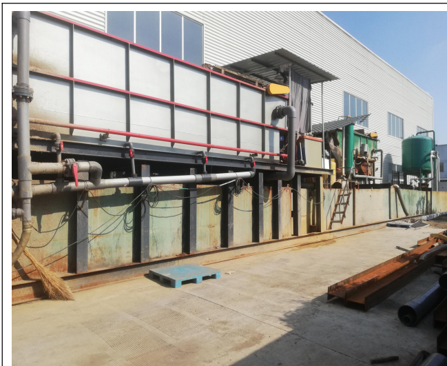
生产废水循环处理设施
