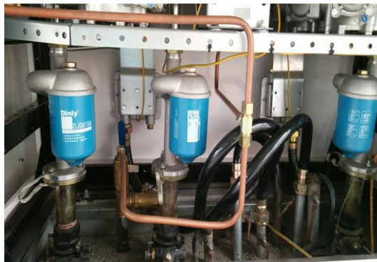
油气回收装置
