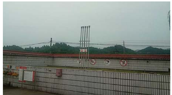
油罐区及通气阀
