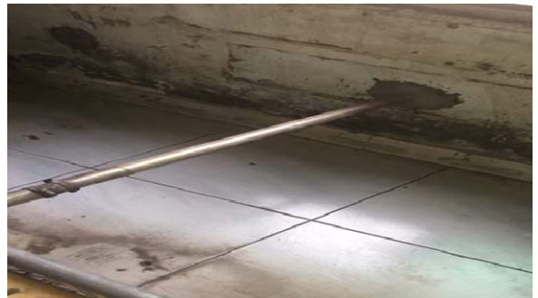
柴油发电机废气排放管道
