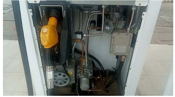
二次油气回收装置
