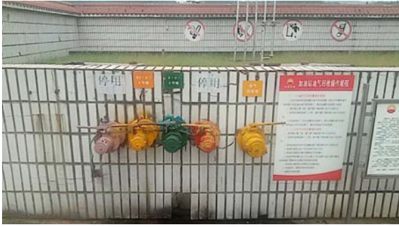
卸油口及一次油气回收装置
